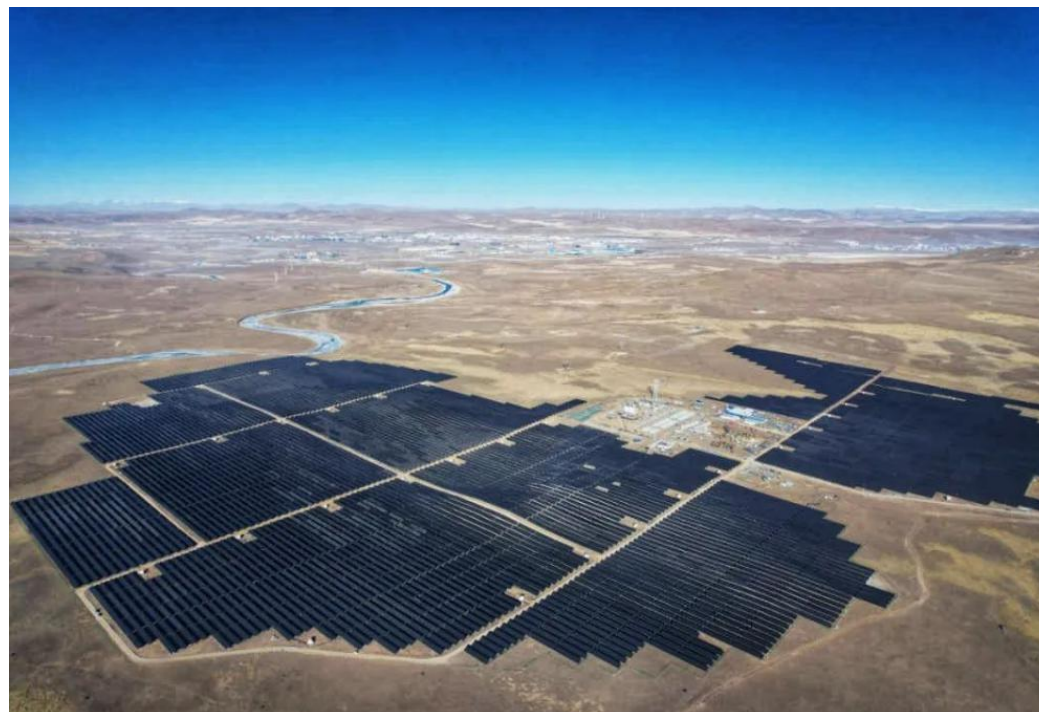
西藏最大光储电站全景鸟瞰
